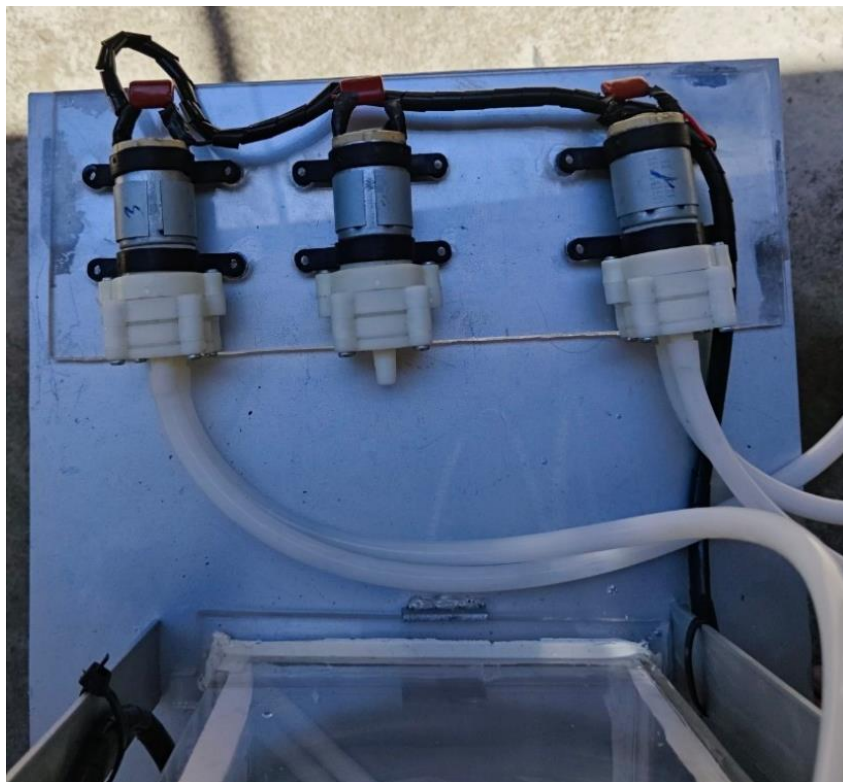
Hình 2-13 Ảnh thực tế vị trí lắp đặt các bơm
