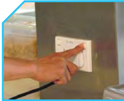
ĐẢM BẢO CÔNG TẮC ĐIỆN VÀ DÂY ĐIỆN AN TOÀN
