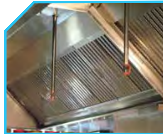
KIỂM TRA LƯỚI LỌC CỦA QUẠT THÔNG GIÓ XEM CÓ SẠCH KHÔNG
